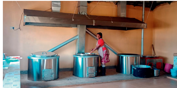
Die modernen Kochstellen der neuen Küche machen das Kochen effizienter und sicherer.
